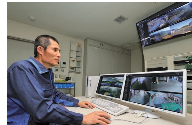
Imágenes de vídeo de todo el parque vistas desde una sala de control central
