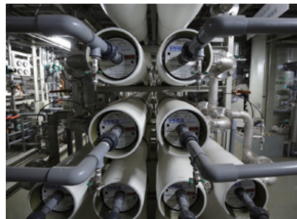
キヤノン(株)宇都宮工場の排水ろ過装置
