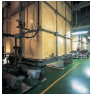
六面点検型排水設備
