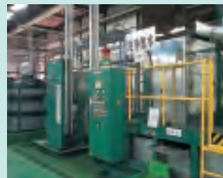
樹脂洗浄脱水設備
