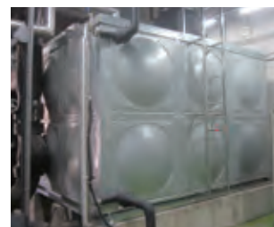
ドレーン水を貯水するタンク
