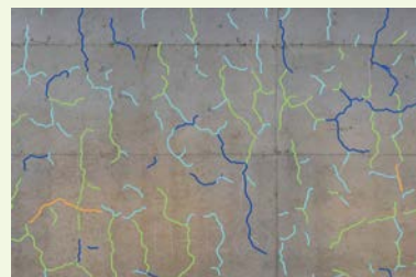
AIによるひび割れ検知
