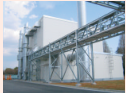
直接燃料を燃焼させ電気と蒸気を発生させるコージェネレーションシステムを大分キャノンマテリアルとキャノン化成で導入
