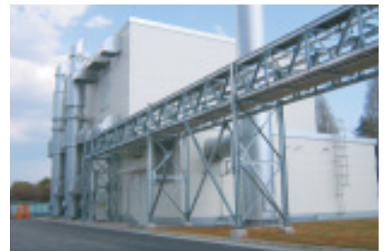
コージェネレーションシステム外観 (キヤノン化成岩間事業所)
