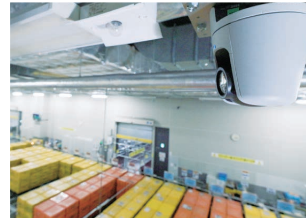
Netzwerkcameras unterstützen die Logistik und Bestandsverwaltung
