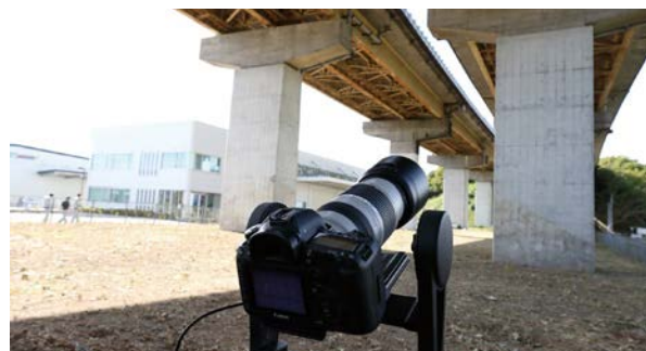
コンクリート構造物のひび割れをAIで検知
