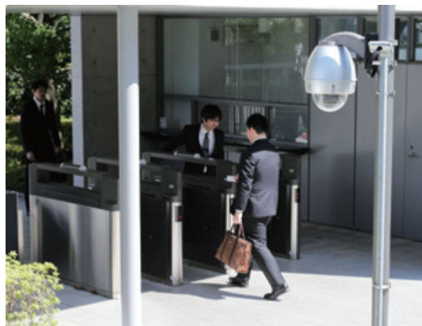
ネットワークカメラにて入退室を監視
