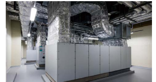
クリーンルーム用に更新した高効率空調機
