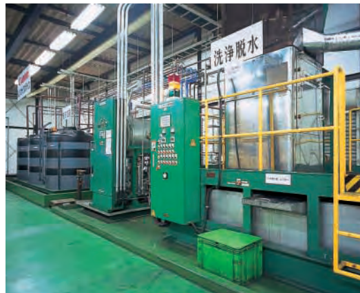
樹脂洗浄脱水設備(CROC)
