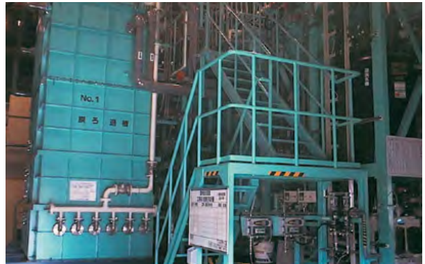
新クローズド排水処理システム(膜ろ過装置)
