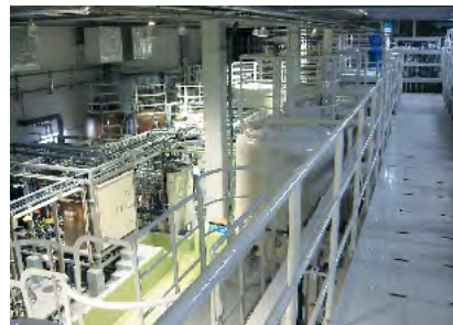
新排水処理システム全景(平塚事業所)
