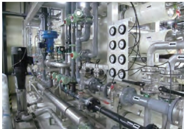
純水製造設備
